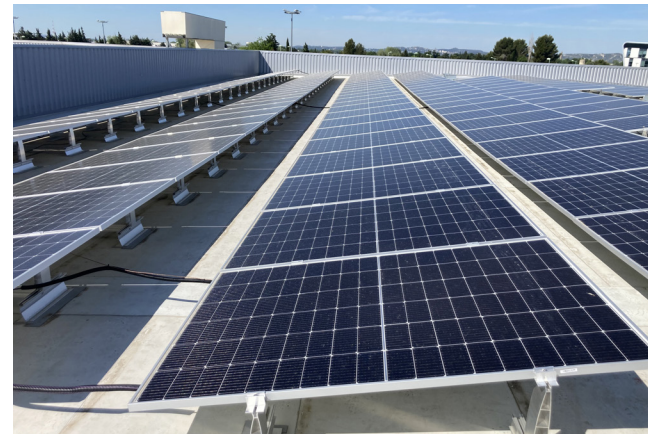
Toiture photovoltaïque pour Cash piscine Sorgues
