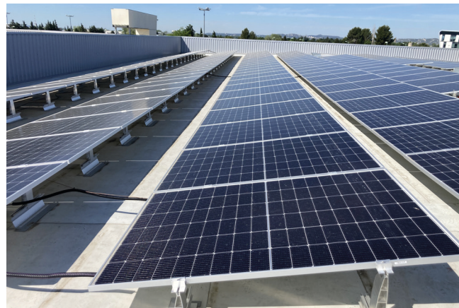
Toiture photovoltaïque pour Cash piscine Sorgues
